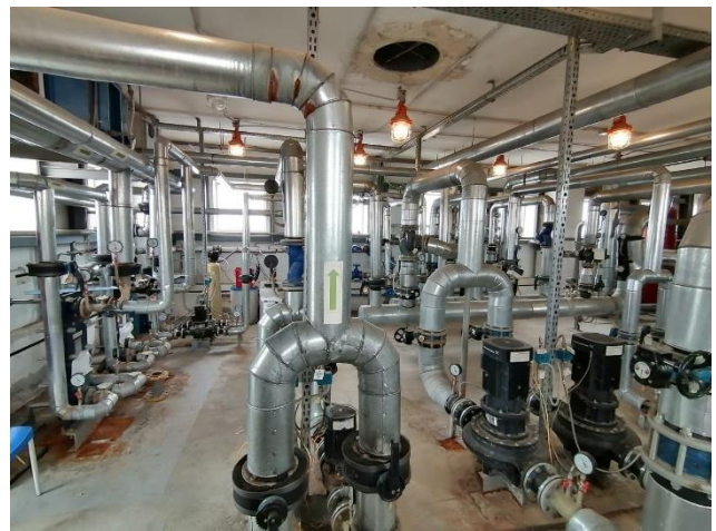
Фото 20. Котельная (6-ой этаж)
